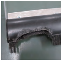
樹脂フレームでは、ネズミが齧って通過します。
